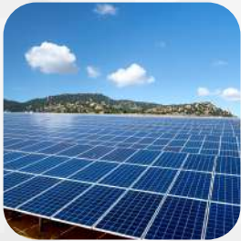
Güneş Enerji Santralleri
